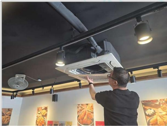
冷暖房機省電力装置の設置 #2
