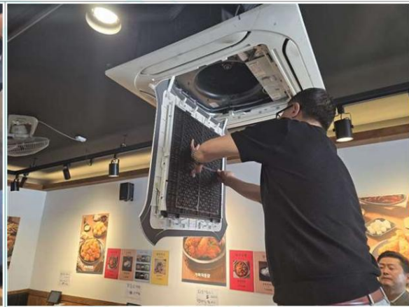
冷暖房機の省電力装置の設置 #1
