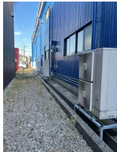
エアコン室外機
