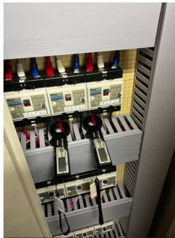
分電盤内に電力ロガーにて計測
